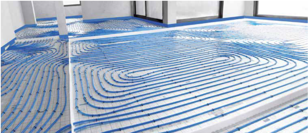
Рис. 25. Підлогове опалення/охолодження зроблене в системі KAN-therm Tacker.
